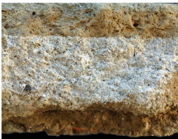
Fig. 26. Strato argilloso (in alto - via S. Maria alla Porta, 9).
